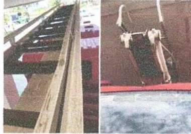
Imagen sistema de escalera (deslizantes) golpeados, N-04
